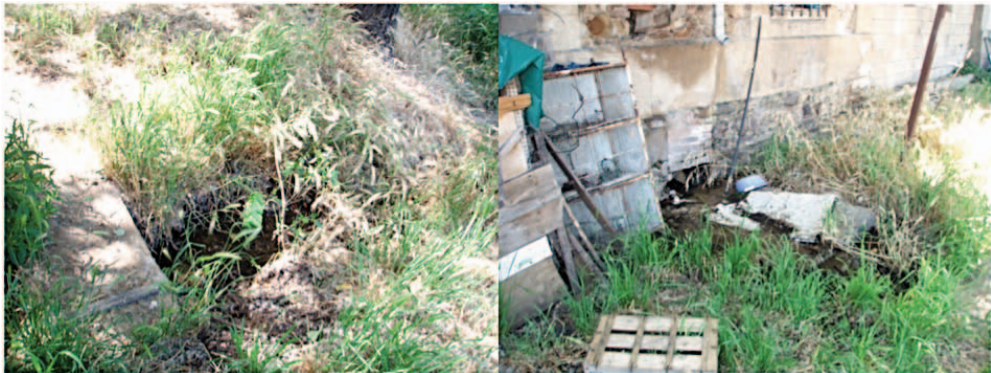
Figura 5. Estado de la red de saneamiento en los Pabellones del Oeste
